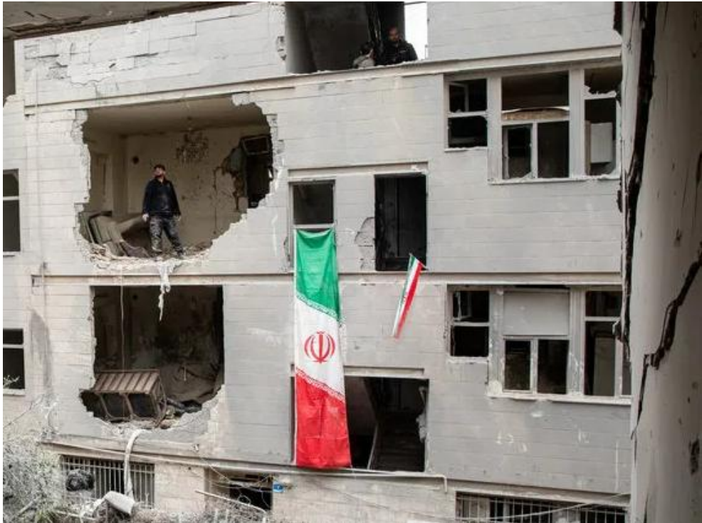
شکل ۳ جدایی قاب پنجره از دیوار و فرو ریزش دیوار پیرامونی (تهران، اسفند ۱۴۰۴)
